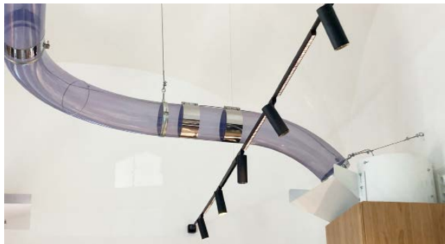
Figura 12. Tubi di posta pneumatica in farmacia per il recapito di farmaci dal magazzino al banco di consegna (Aerocom)
