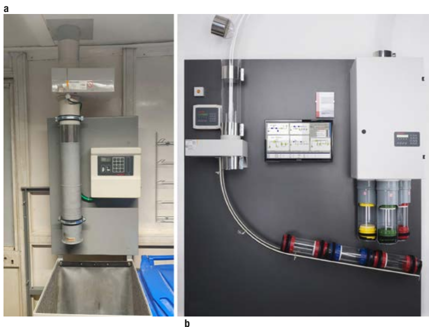
Figura 8. Sistema di posta pneumatica AC-2 (a) e sistema di posta pneumatica AC-3000 (b) (Aerocom)
